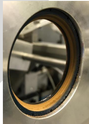
RWDR mit Abrieb nach 24-stündigem Versuch
